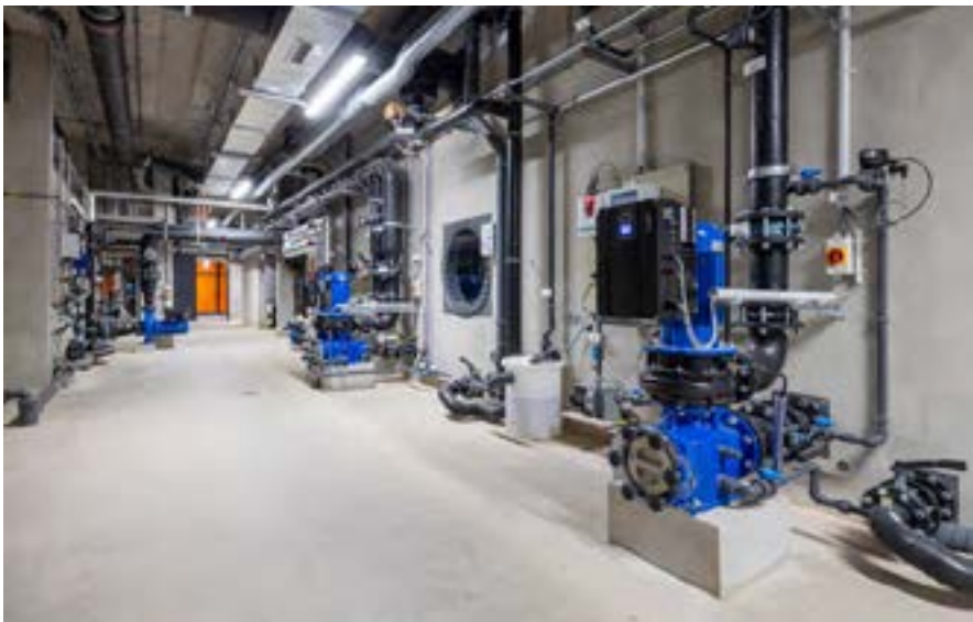
← Die gesamte TGA befindet sich im Kellergeschoss, hier die Filter- und Dosiertechnik, sowie ...
