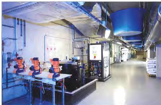
■ Leinenabwurfbehälter (oben rechts) und Membranzellenelektrolyse zur Herstellung der Chlorbleichlauge
